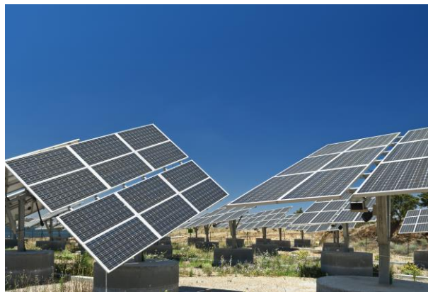
impianto ad inseguimento
