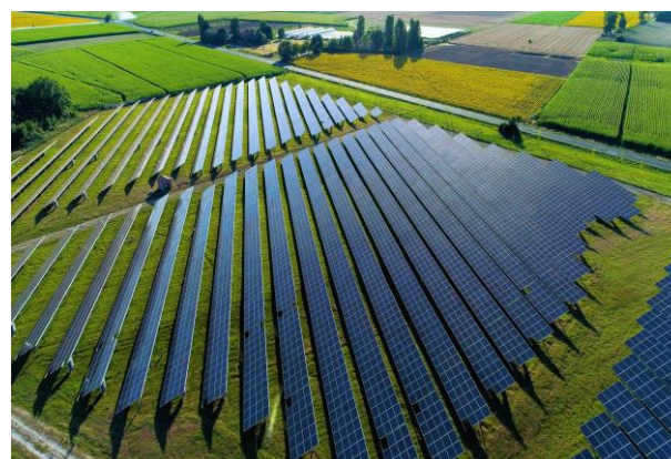
impianto a terra
